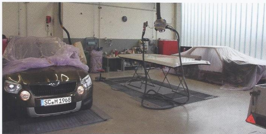
Lackvorbereitung: hier der Blick auf drei Universalarbeitsplätze von Wolf Anlagen-Technik. Absaugung, Herkules-Hebebühne und Energieampeln gehören zur Ausrüstung
